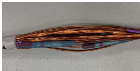
图8 导线压接处试验后状态
