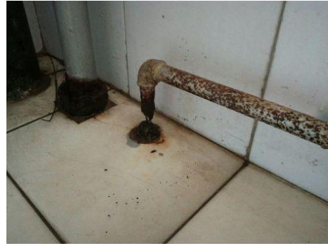
静园D三层水房暖气管腐蚀
