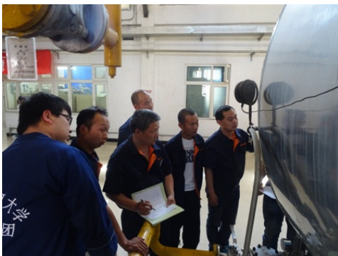
锅炉厂家对运行人员培训
