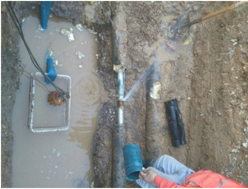
静园 D 西漏水
