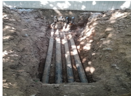
至善园室外管道腐蚀
