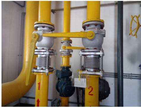
关闭 2#炉燃气总阀
