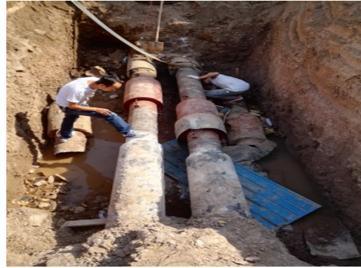
南区花园漏水加压检查
