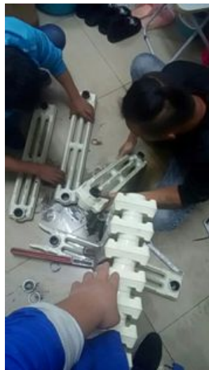
疏桐园 B 暖气片堵塞、清理
