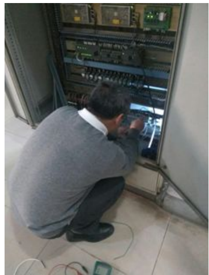
供暖控制柜零件故障
