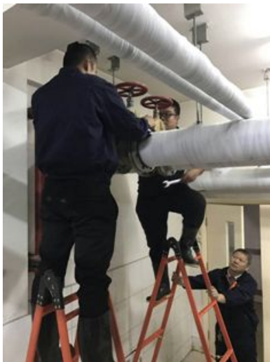
2#食堂总阀门阀芯脱落、更换
