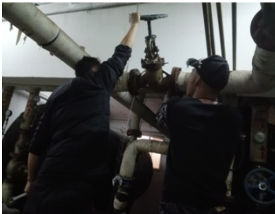
疏桐园 C 拆除阀芯脱落阀门
