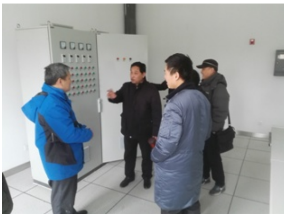
锅炉房监控室
