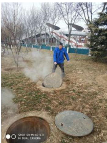
打开暖气井盖
