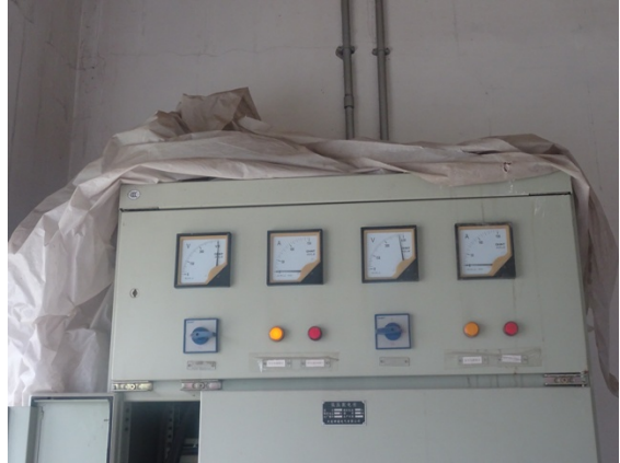
供暖 1 号交换站房顶漏水
