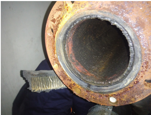
法兰处有大量焊渣
