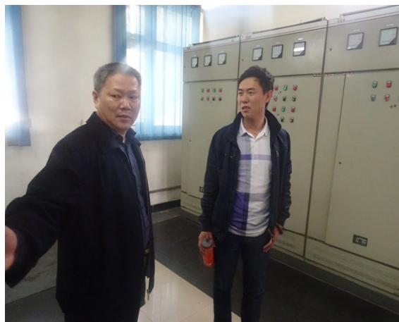
配电室总闸故障
