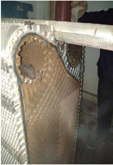
板式换热器内有杂物
