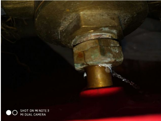
丹枫园四层漏水总阀门
