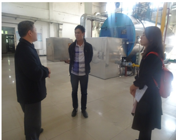
3 台锅炉运行状况
