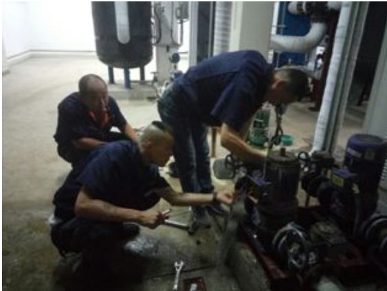
排查掉闸故障原因
