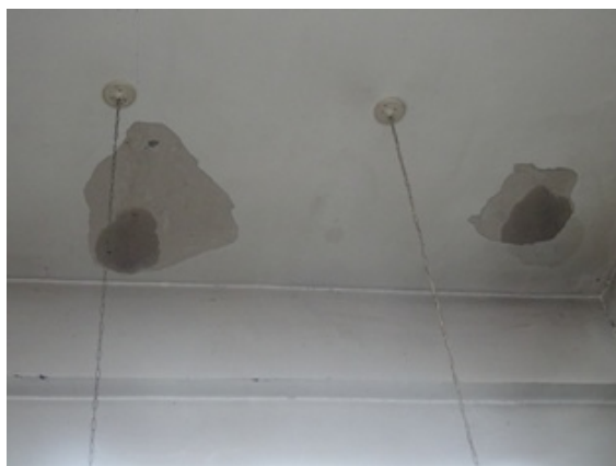
锅炉房值班室房顶漏水
