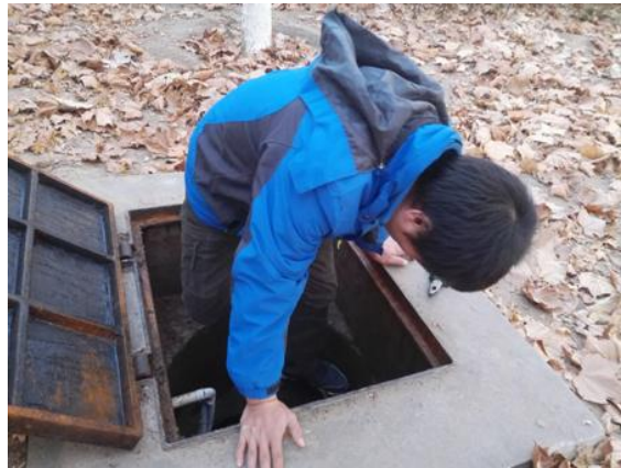
供暖节能减排井设备检查
