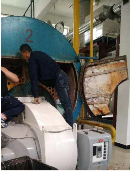
检查脱落隔热层
