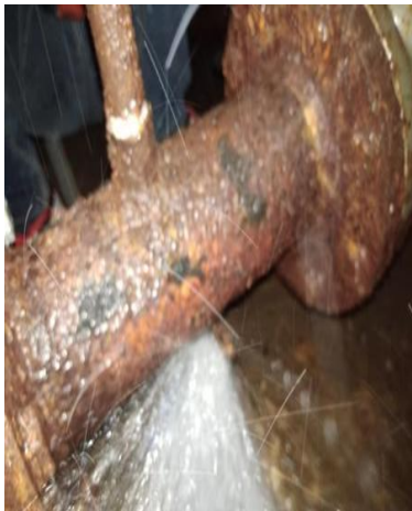
管道锈蚀漏水
