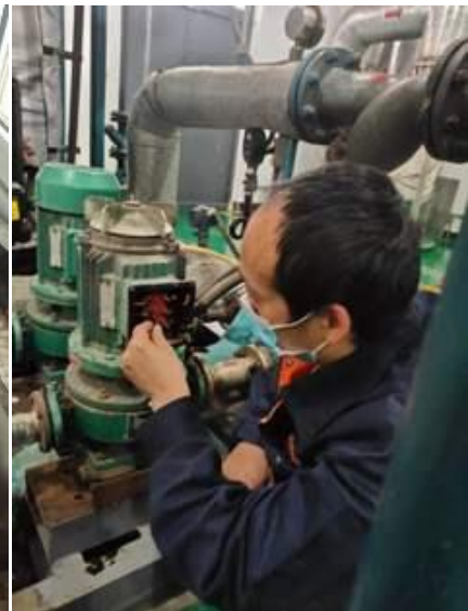
排查循环泵故障
