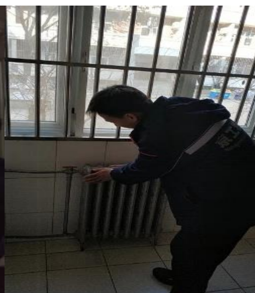
入楼测量温度
