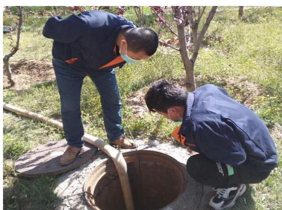
积水井抽排水
