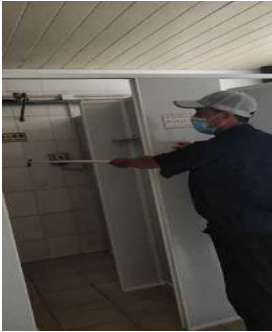
排放设备生锈存水
