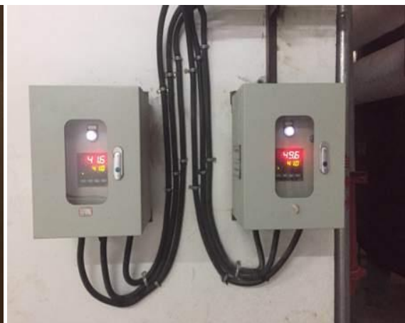
动力中心交换站
