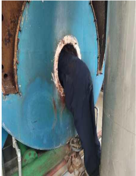
锅炉炉膛检验
