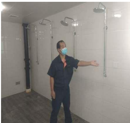
浴室水温巡查
