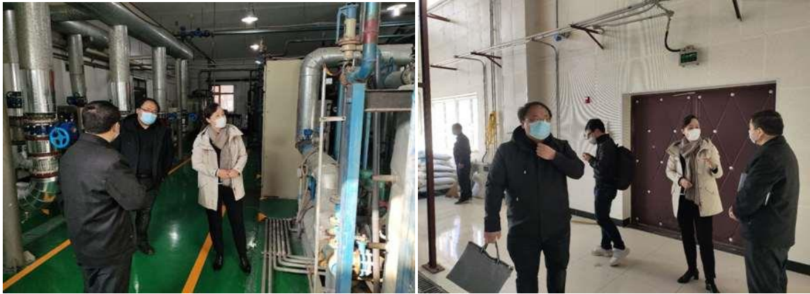
物业服务中心经理张毅珍带队巡检良乡供暖锅炉房、换热站
