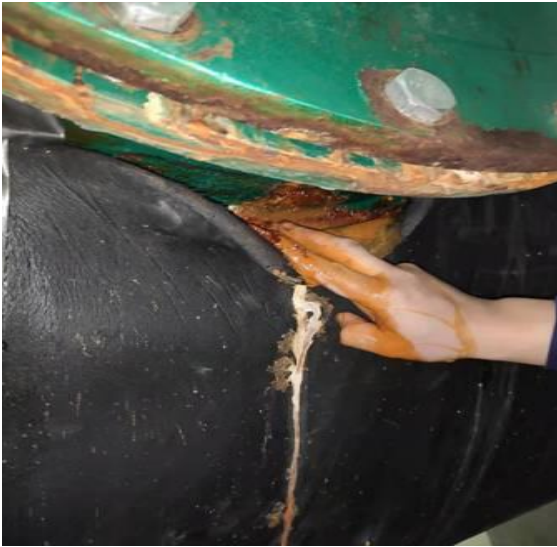
查找漏水原因
