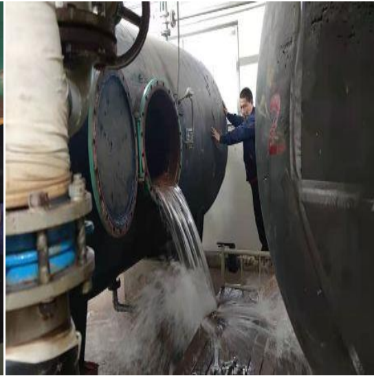
打开换热罐泄水、泄压
