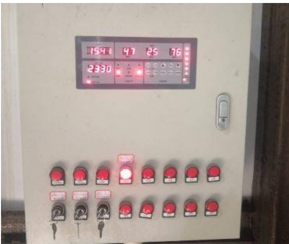
静园太阳能换热站
