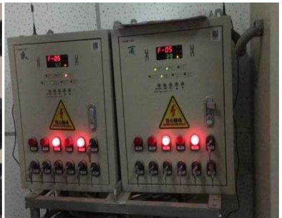
留学生洗澡换热站
