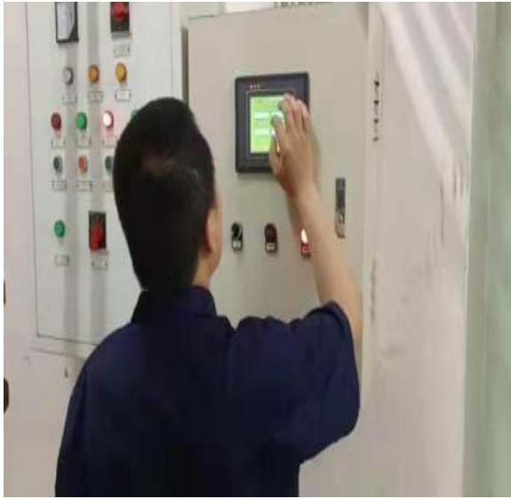
调整洗澡设备运行时间
